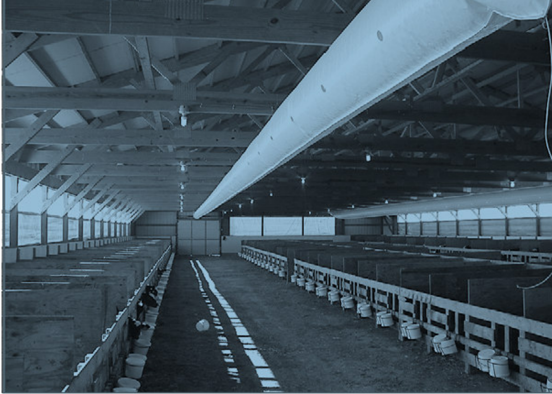
Şekil 1. Doğal bir ahıra kurulan pozitif basınçlı havalandırma kanalı
